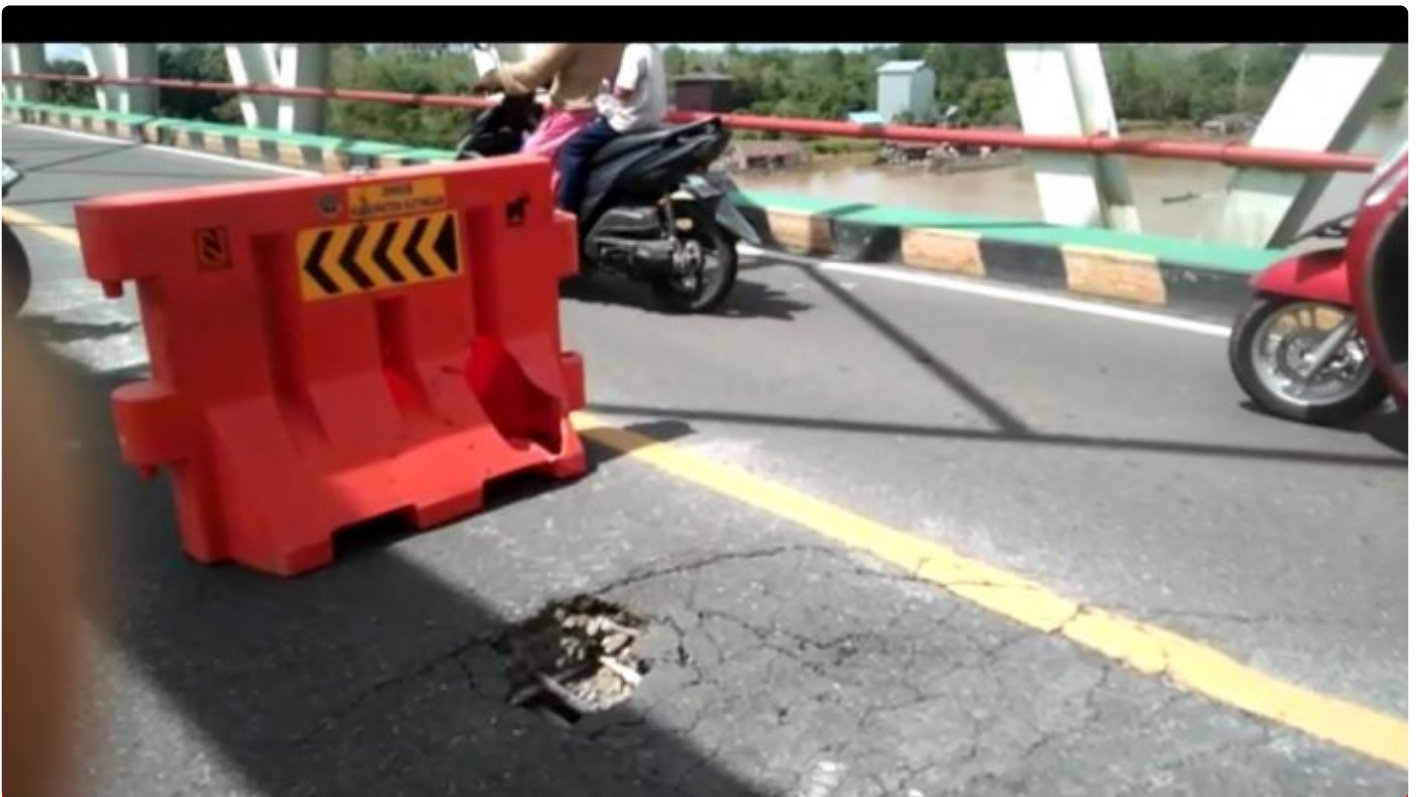
Gambar: Kondisi Jembatan Sei Katingan/Kasongan Yang Berlobang dan retak
